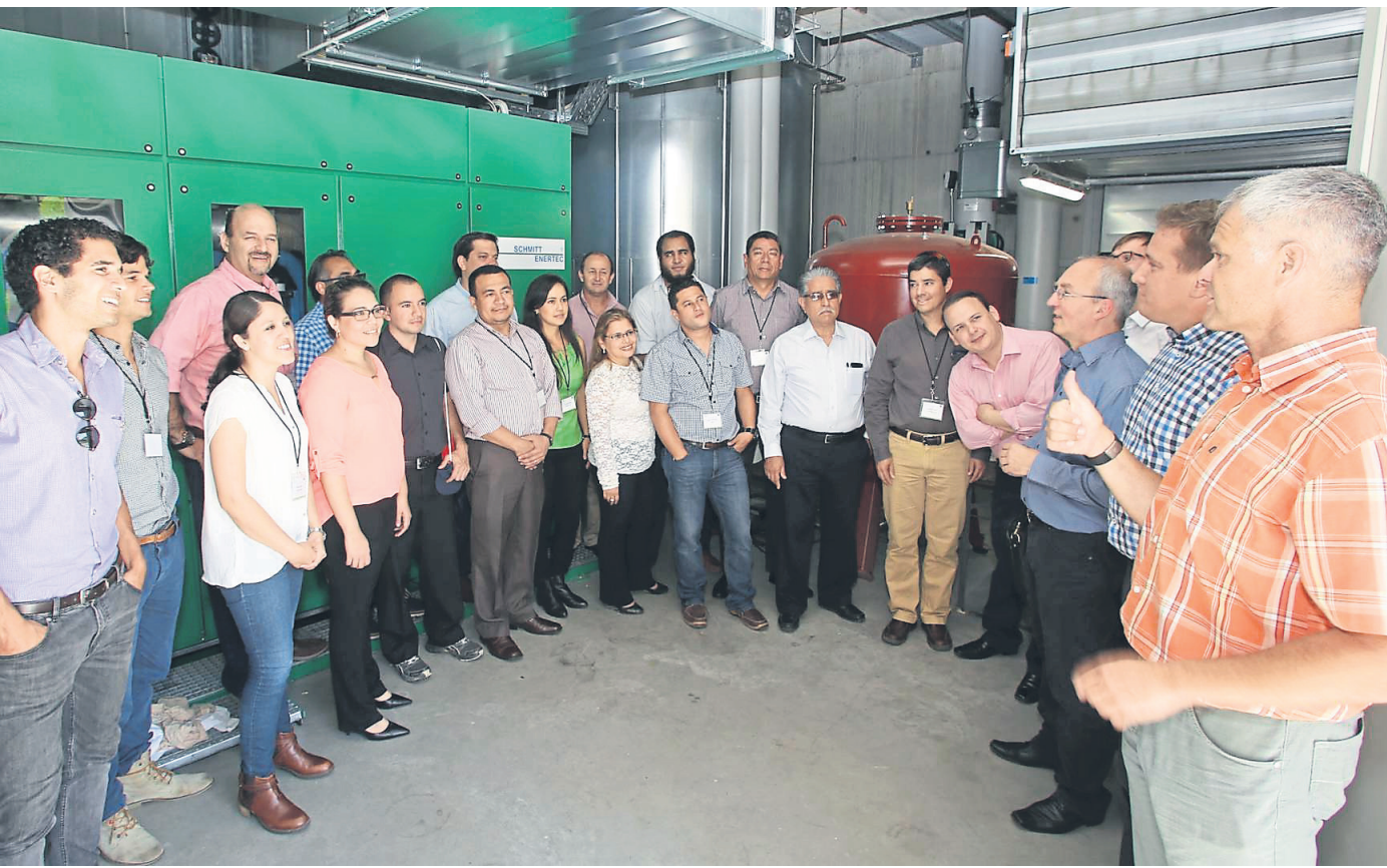
Energie gewinnen und gleichzeitig Wärme: Der Tölzer Stadtwerke-Chef Walter Huber erläutert der Delegation aus Zentralamerika die technischen Details des Blockheizkraftwerks an der Osterleite.
